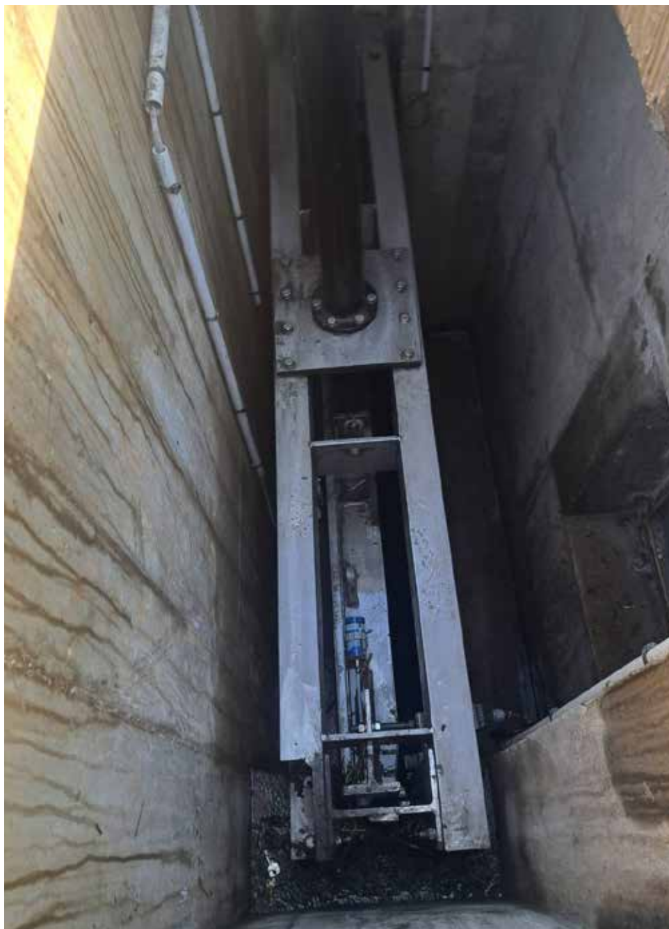
Vanne murale à commande hydraulique
