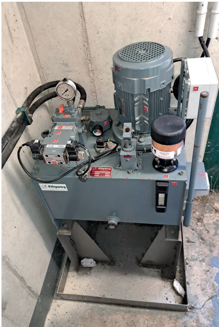
Centrale hydraulique assurant la commande motorisée d'une vanne
