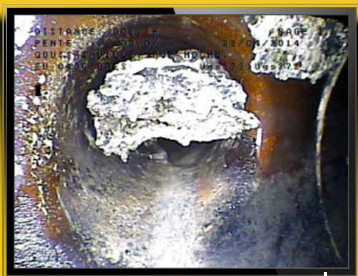
Sur cette image prise par une caméra depuis l'intérieur d'une canalisation on aperçoit en blanc un amas de graisse solidifiée
