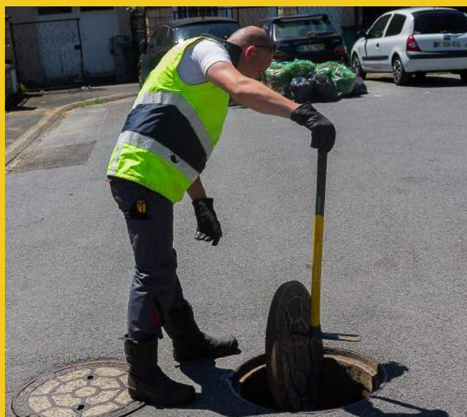
les agents du SIAH interviennent tous les jours sur les réseaux de façon préventive ou corrective
