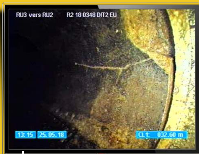
Ici la caméra s'est arrêtée sur une fissure horizontale
