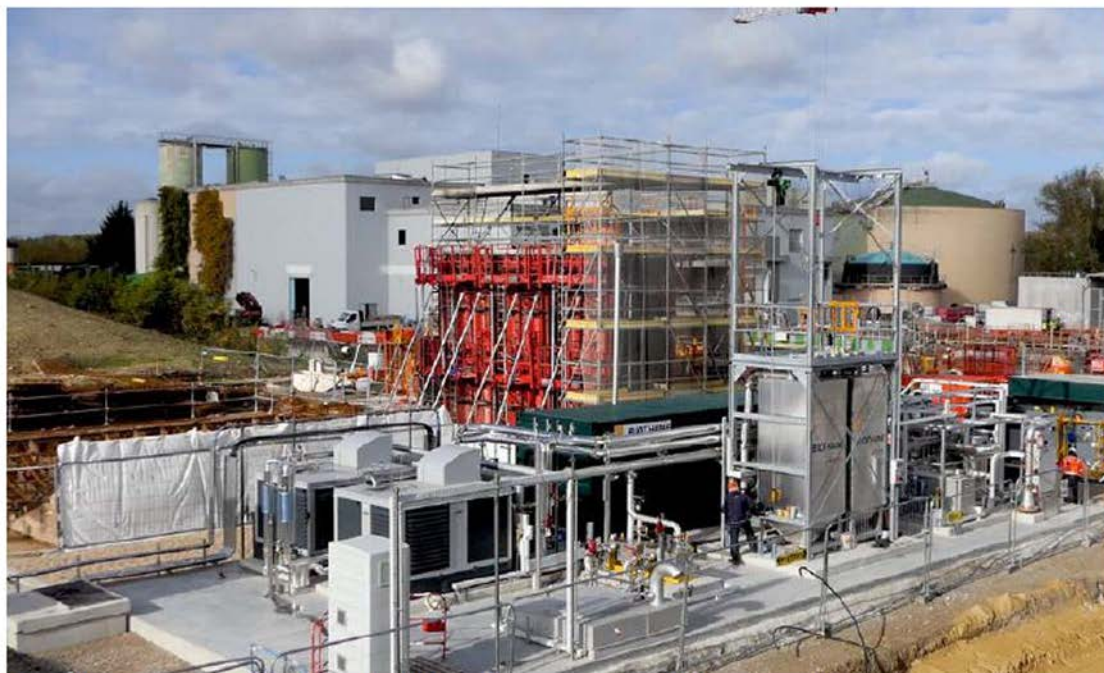
Le méthane est produit à base de déchets des eaux usées de la station d'épuration.
