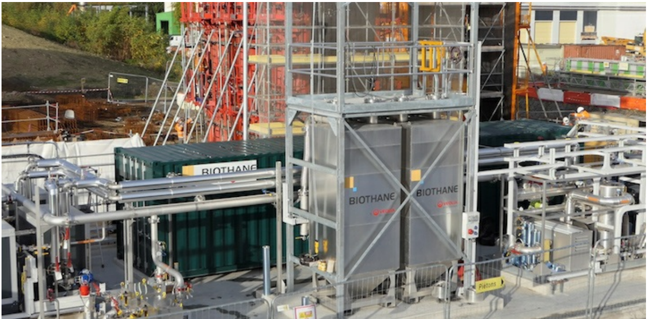
Les nouveaux équipements d'épuration du biogaz à la STEP de Bonneuil, photo SIAH
