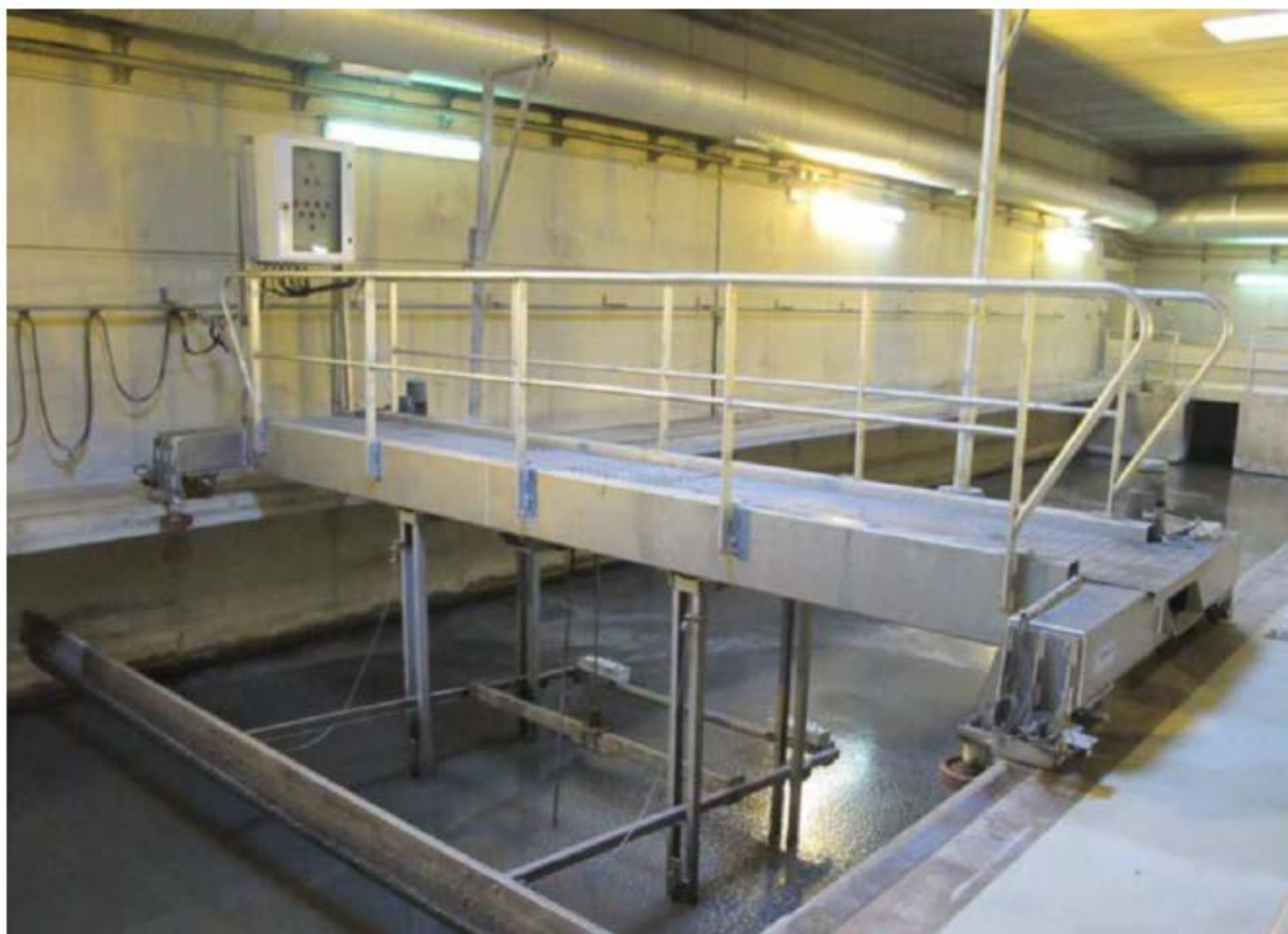
Bonneuil-en-France, le 26 août. Cette structure traite les eaux usées de 300 000 habitants, répartis sur 35 communes. D'ici à l'horizon 2020, il lui faudra gérer les rejets de 500 000 personnes. (LP/A.L.)
