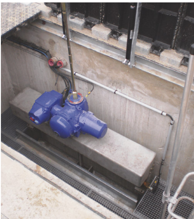
↓ Vue sur la motorisation de la vanne hydraulique
