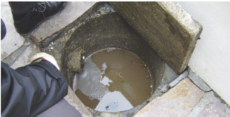
↑ Exemple de dégorge- ment suite à une obturation d'une canalisation
