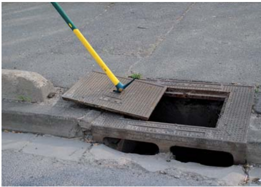
↑ Inspection d'un avaloir : le réseau doit assurer la bonne évacuation des eaux pluviales.
