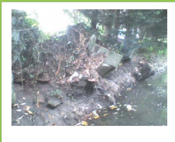
↑ Au bout de l'avenue du Stade à Sarcelles, le Petit Rosne présentait plusieurs désordres liés à l'érosion des berges. L'image ci-dessus montre l'état des berges avant intervention. Les blocs de béton visibles sont en fait un mur qui s'est écroulé à cause de la détérioration des berges érodées par l'eau. On le distingue à peine sur cette photo mais la renouée du Japon occupe une bonne part de la berge (voir notre article central).
